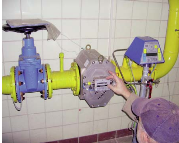
⑧ Gasmengenzähler: Energieeffizienz wird am Verbrauch gemessen
